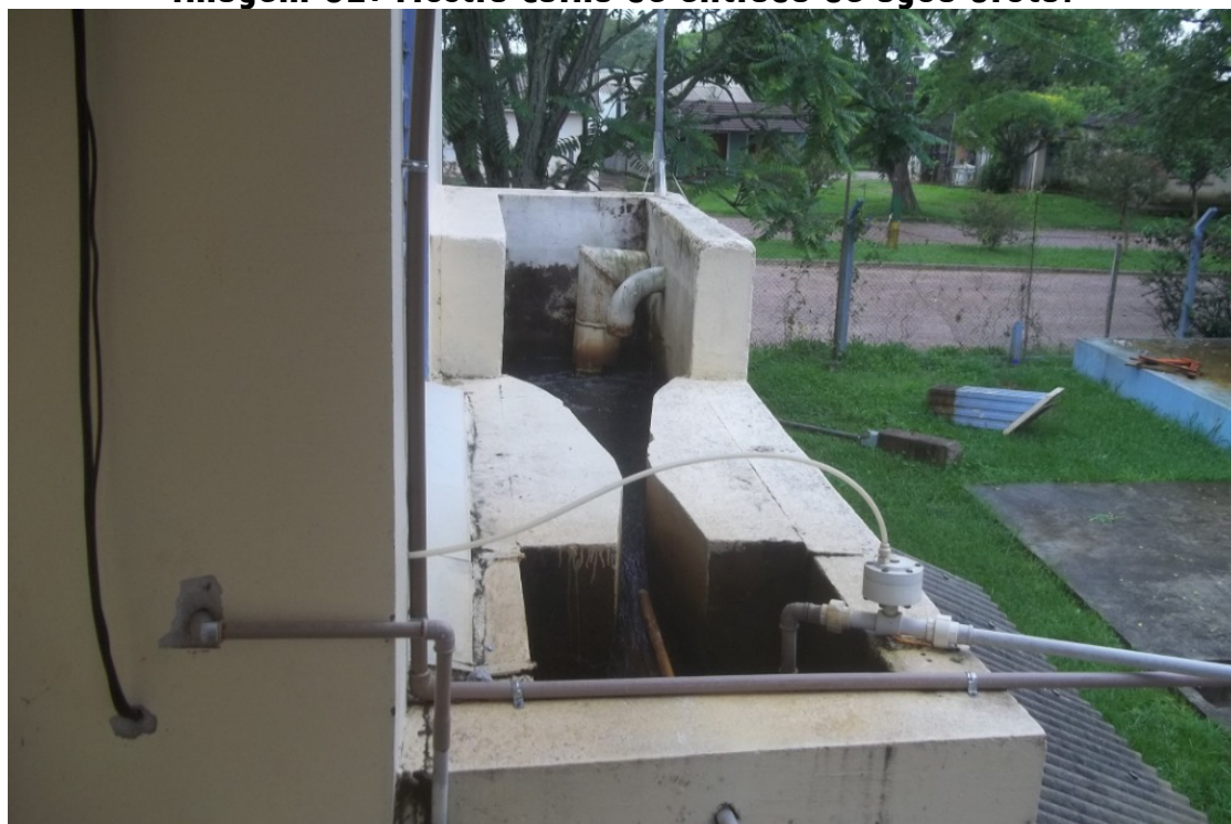
Imagem 02: Mostra calha de entrada de água bruta.
