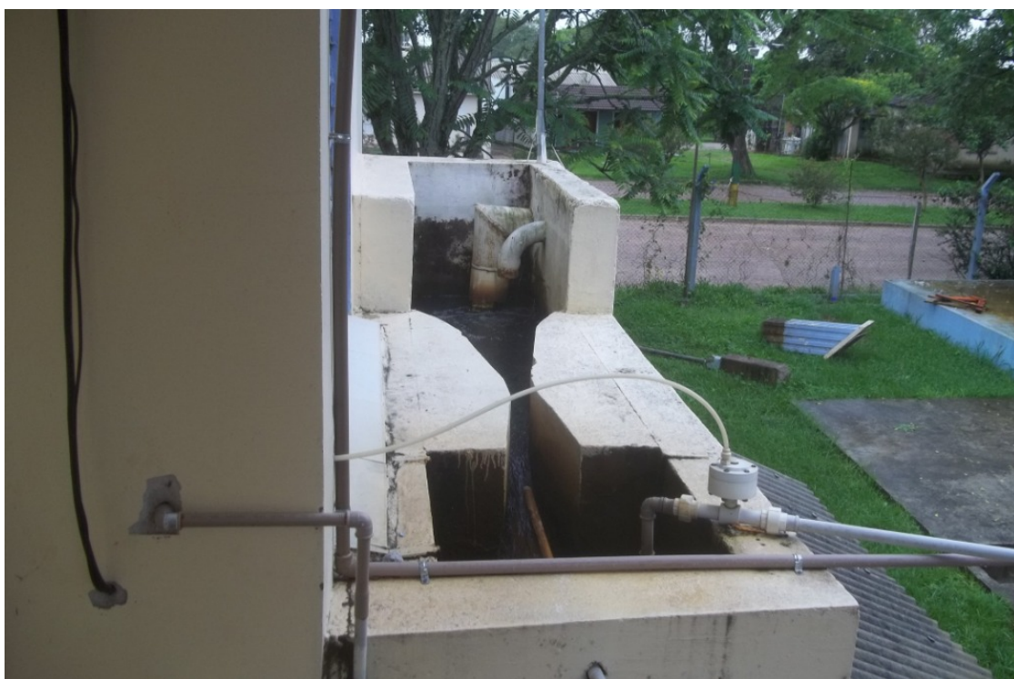
Imagem 02: Mostra calha de entrada de água bruta.
